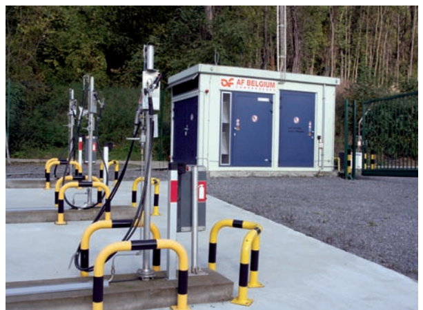
Nouvelle station de gaz naturel qui alimente les véhicules de l'Institut.
