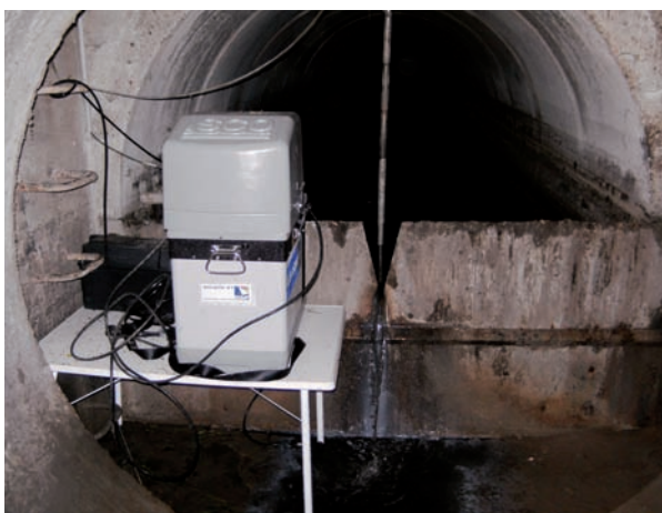
Echantillonneur automatique sur un rejet industriel.
