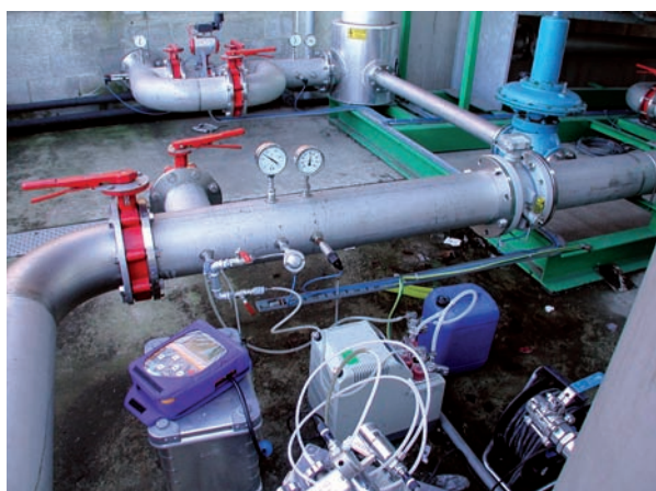
Contrôle de la qualité du biogaz en CET.
