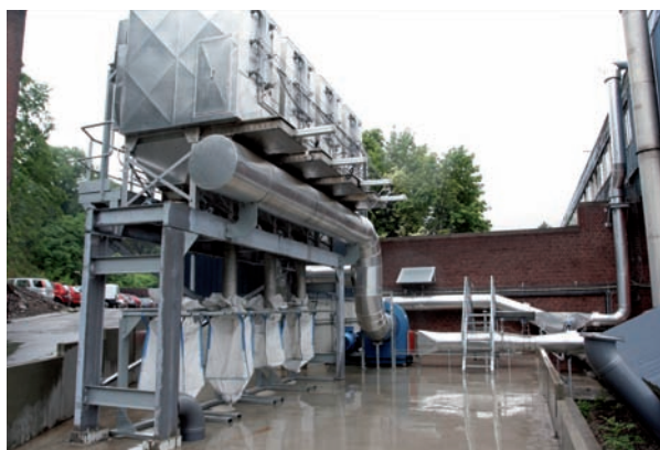
Installation de traitement des effluents gazeux (ISSeP, FRA et ETPW).
