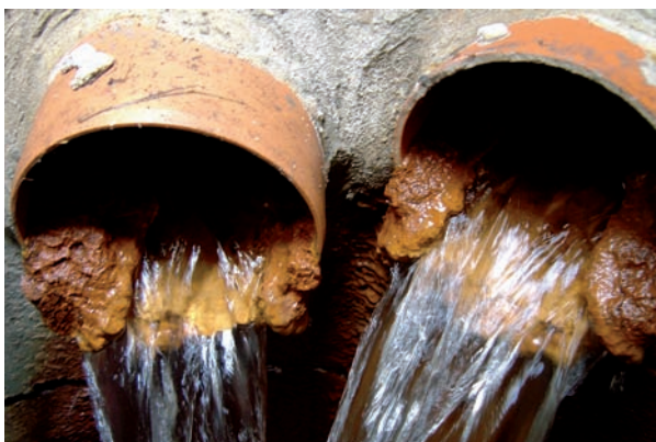
Drains placés sous la rue Steenebrugen collectant une partie des eaux d'exhaure de la zone Wandre-Cheratte.
