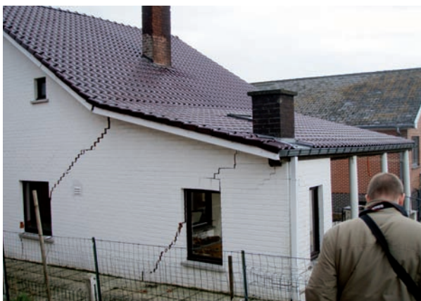
Effets sur le bâti des affaissements survenus dans la région de Saint-Vaast.
