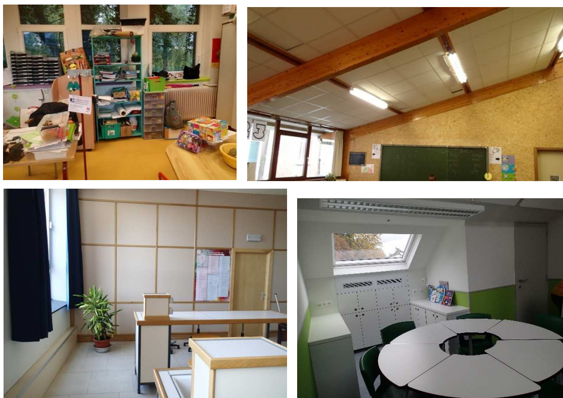
FIGURE 24. SOURCES POTENTIELLES DE FORMALDÉHYDE DANS CERTAINS LOCAUX : NOUVEAU VINYLE AU SOL, CLOISON APPARENTE EN OSB, NOUVELLE PAROI, NOUVEAU MOBILIER.
