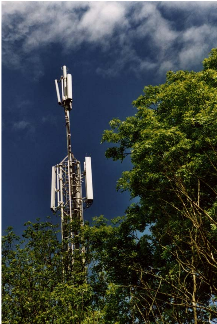
Ansicht eines Mastes mit sechs Sektorantennen
