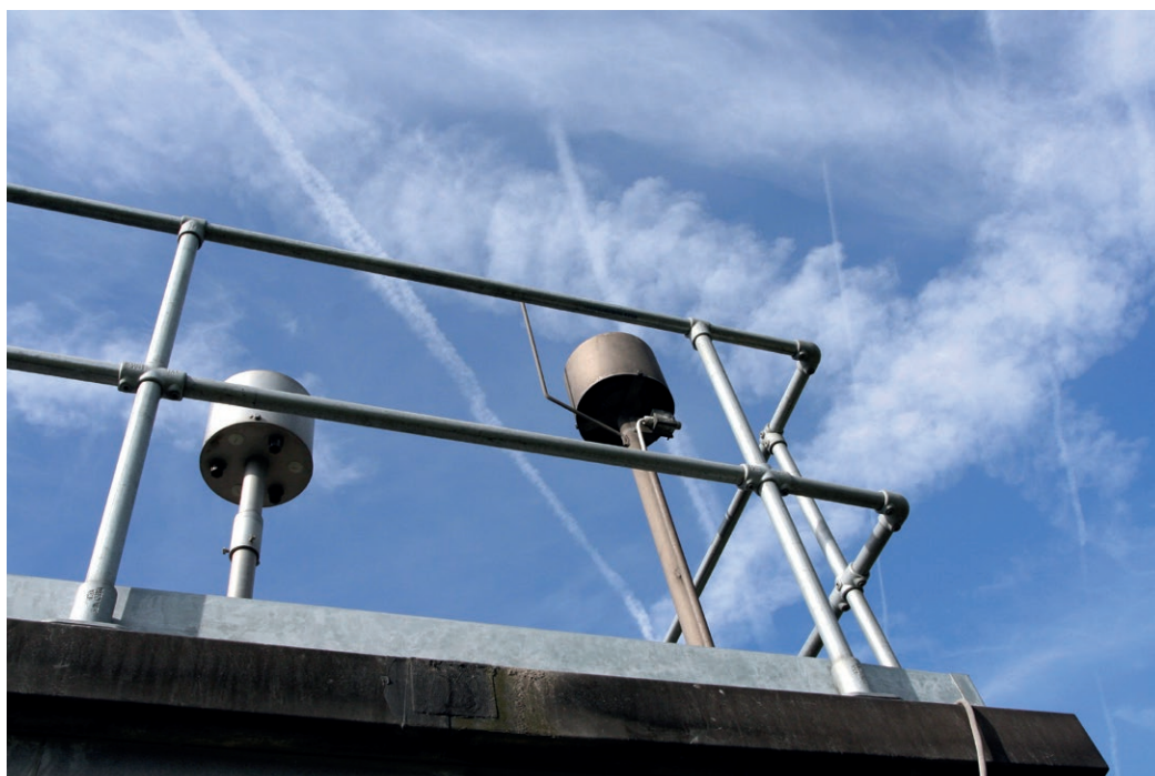
Station télémétrique : Prise d'échantillon d'air ambiant
