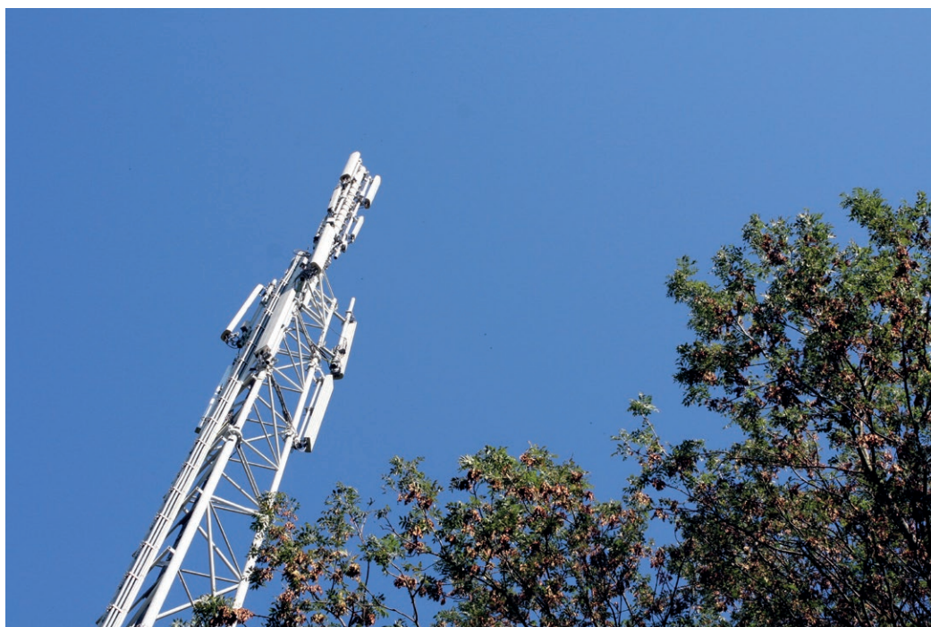
Pylône équipé d'antennes de téléphonie mobile
